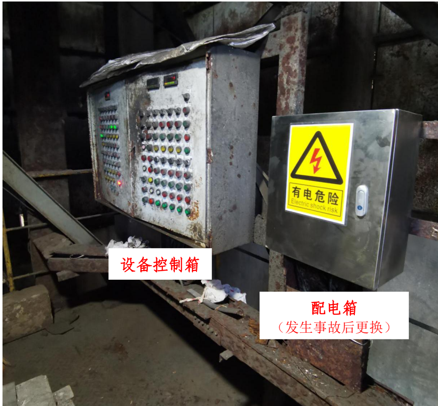
图 4 事故现场照片 3
