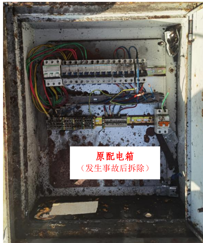
图 5 事故现场照片 4
