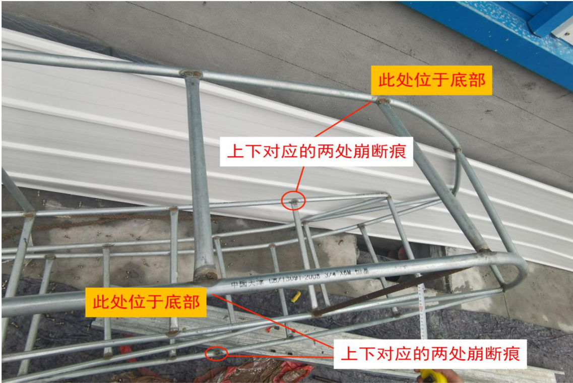
图 4 事故现场照片 3
